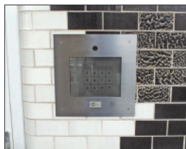
Touchscreen buitenpost ingebouwd in muur
